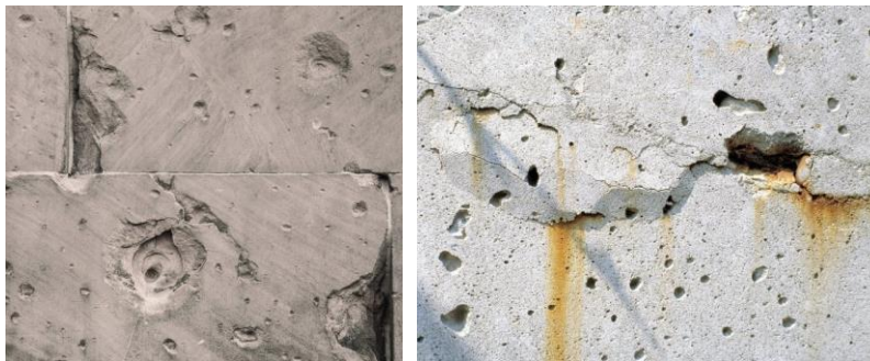
Bild 1: Schäden an einer Betonfassade. Links: Sulfattreiben (Quelle: Free-Photos / Pixabay), rechts: Bewehrungskorrosion (Quelle: www.dbz.de)
